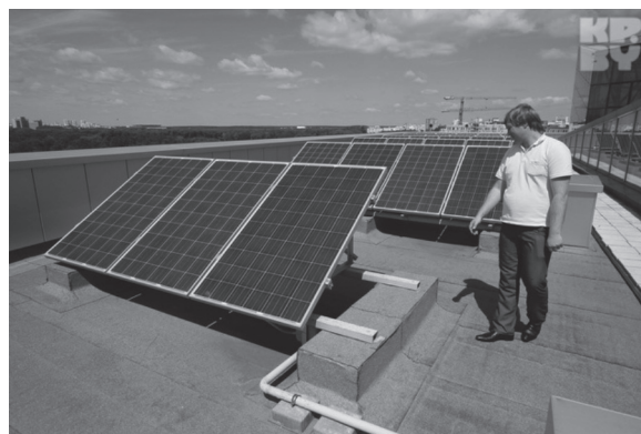
На крыше «кристалла» установлены солнечные батареи
