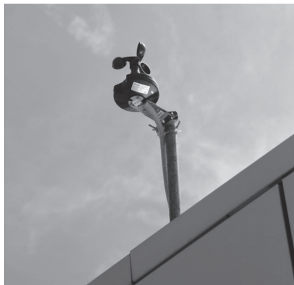
Данные с метеостанции попадают в центральный сервер: если начнется дождь – окна кабинетов и люки атриума закроются автоматически
