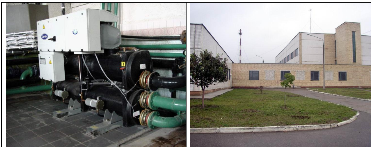
Рисунок 12 – Теплонасосная установка, смонтированная на канализационной станции 19 возле Минска, использующая в качестве источника тепла температуру подземной воды из мелкой скважины, и здание, отапливаемое этой установкой.
