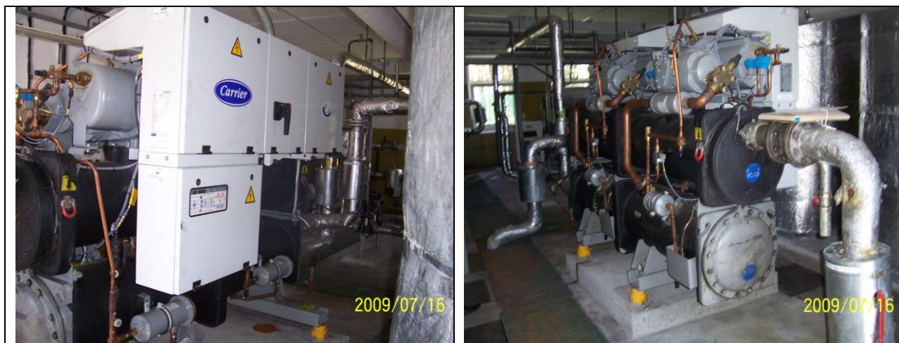
Рисунок 3 – Тепловой насос Carrier Global Chiller 30HXC 080-375 на пограничном переходе «Новая Рудня» в Ельском районе, Гомельской обл.
