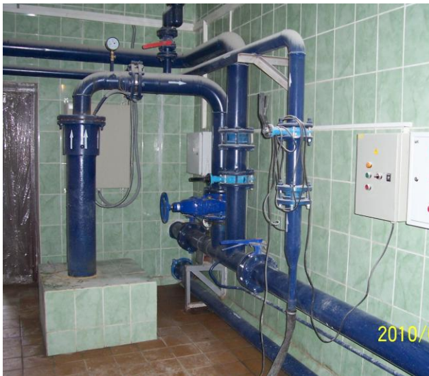
Рисунок 1 – Устье скважины Вычулковская 201 для получения теплой воды.
