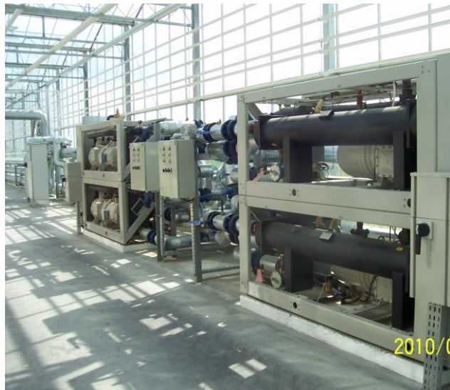
Рисунок 2 – Тепловые насосы фирмы Daikin, геотермальной станции «Берестье».
