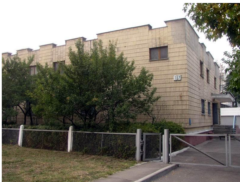
Здание канализационной насосной станции № 6, отапливаемое с помощью геотермальной энергии.
