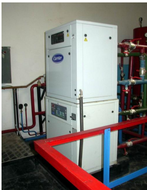
Тепловой насос, установленный на канализационной насосной станции № 6, г. Минск, пр-т Машерова.
