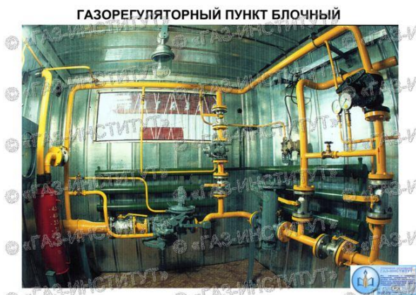
Рис. 8.19. Общий вид газорегуляторного пункта (ГРП)
