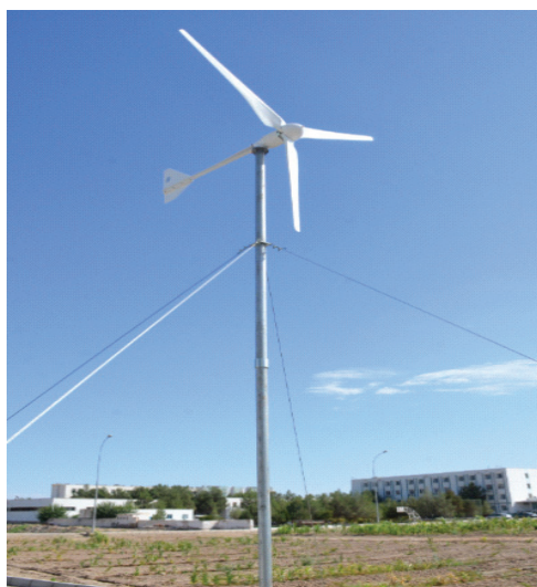
Рис. 2. Ветряная электрическая станция мощностью 2 кВт
