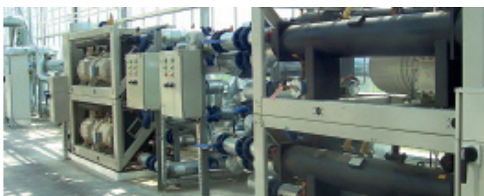
Фото 4. Тепловые насосы Daikin геотермальной станции «Берестье»
