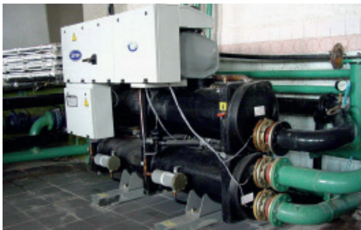
Фото 1. Общий вид теплонасосной установки на КНС № 24, действующей на подрусловой воде р. Свислочь
