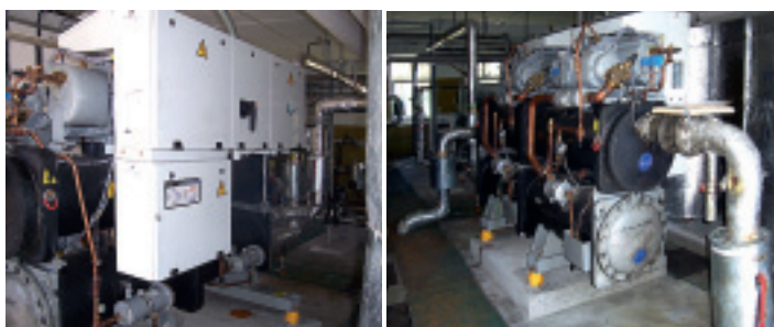
Фото 5. Тепловой насос Carrier Global Chiller 30HXC 080-375 на пограничном переходе «Новая Рудня» в Ельском районе Гомельской обл.
