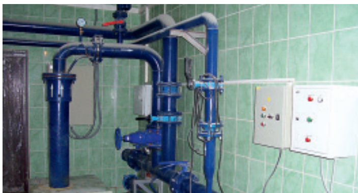
Фото 3. Устье скважины «Вычулковская 201» для получения теплой воды
