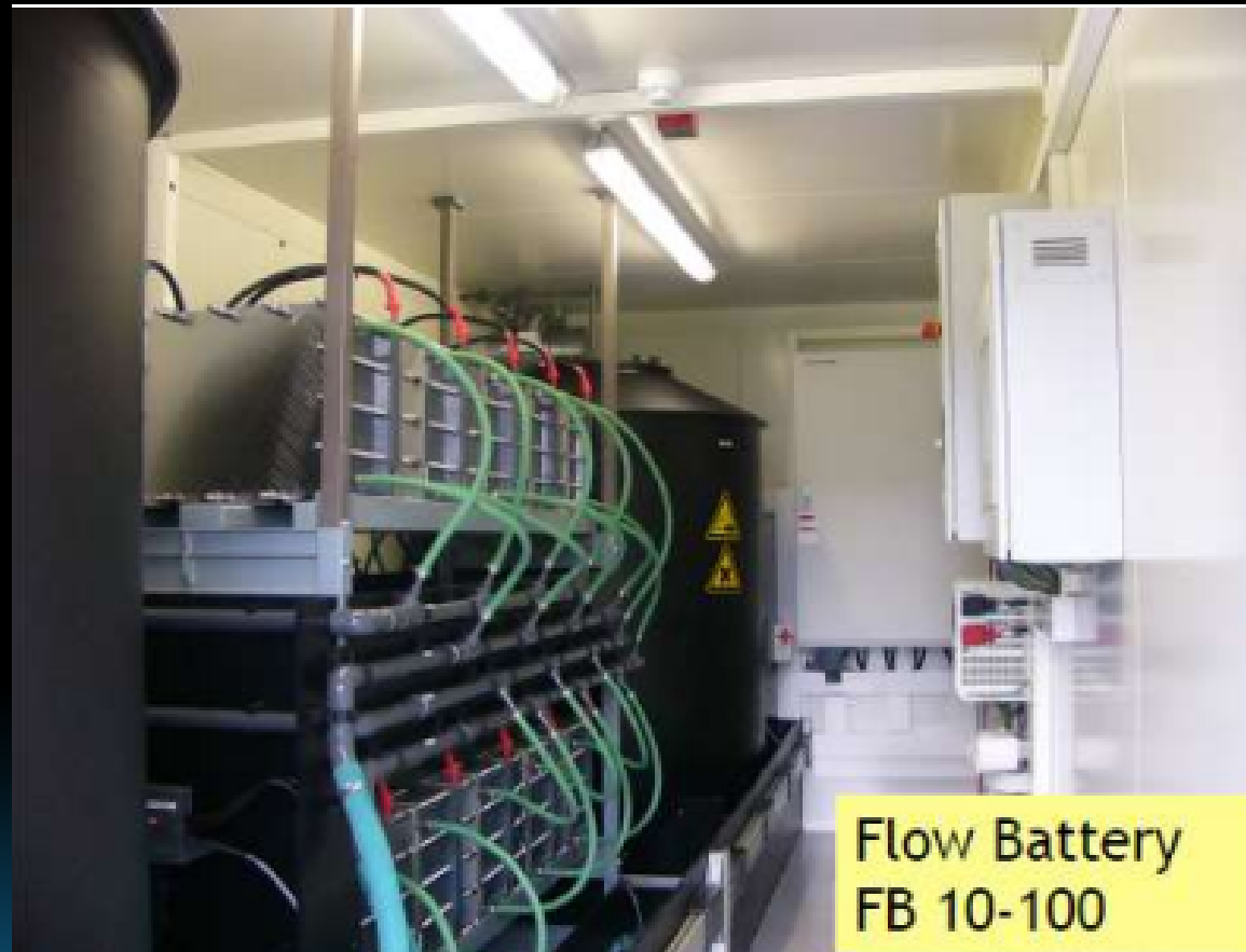
Вид накопителя CellStrom Power FB-10-100 изнутри
